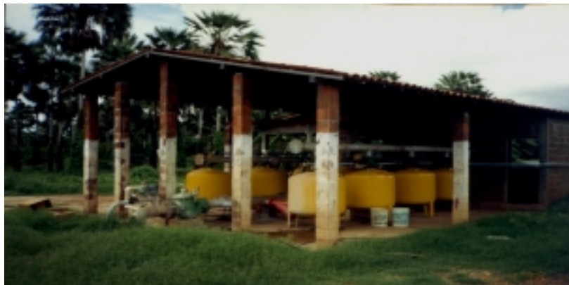
Foto 1.7 - Cabeçal de Controle do sistema de gotejamento da AGRÍCOLA CAJAZEIRAS (130 ha)
